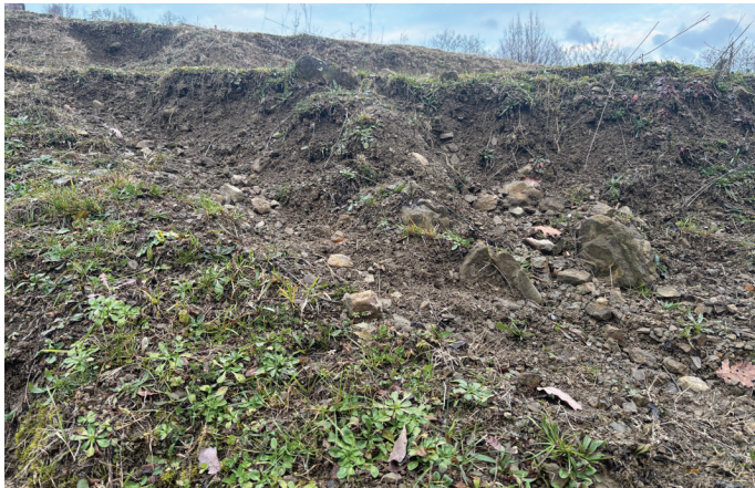
01 FIGURA Erosione idrica
